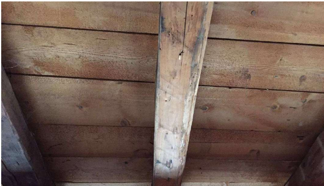
Immagine di dettaglio solaio parte ovest con tavolato dopo la rimozione delle strutture metalliche
