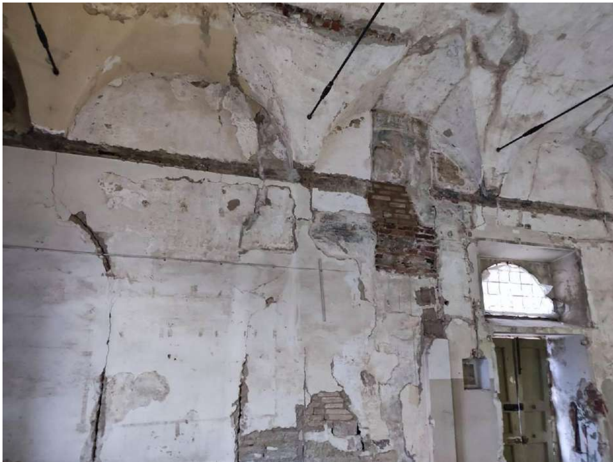
Fig. 16 – Dettagli scuci cuchi parete nord – sala dello Zodiaco
