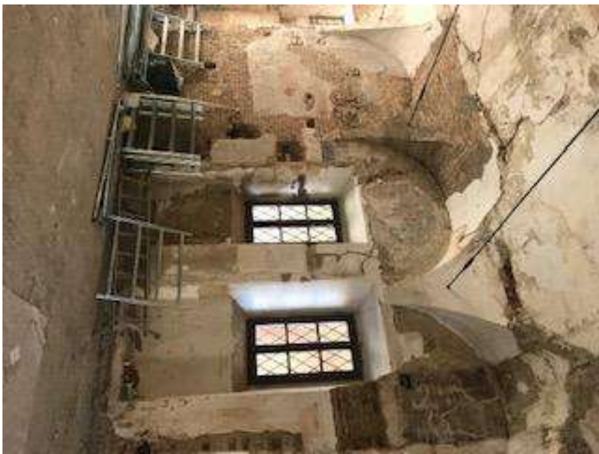
Fig. 17 – Dettagli scuci cuchi parete nord – sala dello Zodiaco
