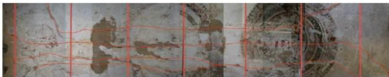
Fig. 2 – Mappatura realizzata dall'impresa di restauro del quadro fessurativo che attualmente attraversa longitudinalmente la volta
