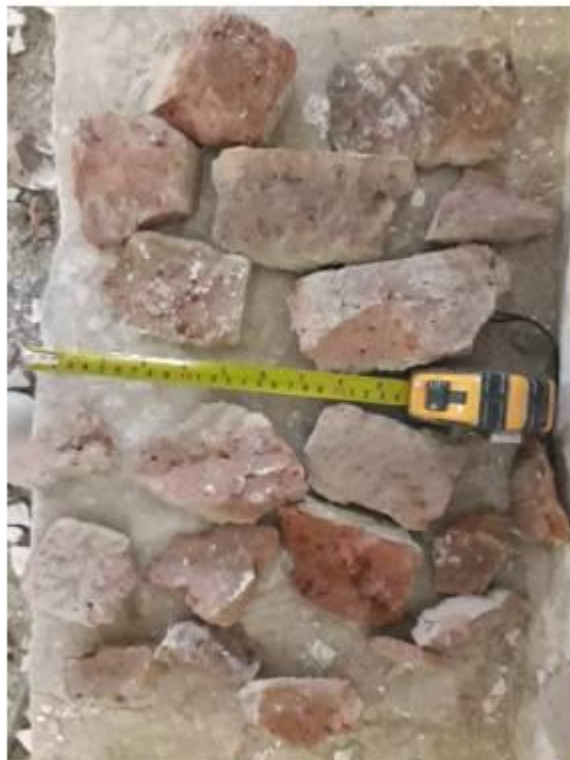
Fig. 3 – Parti di mattone caduto
